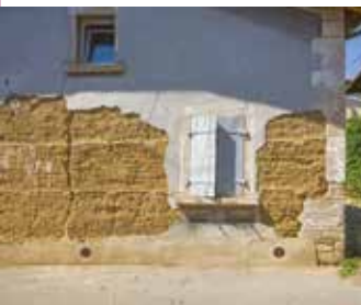
Façade d'une ferme dont l'enduit s'est partiellement détaché, Ars-sur-Formans (01) © philippehervouet.fr
